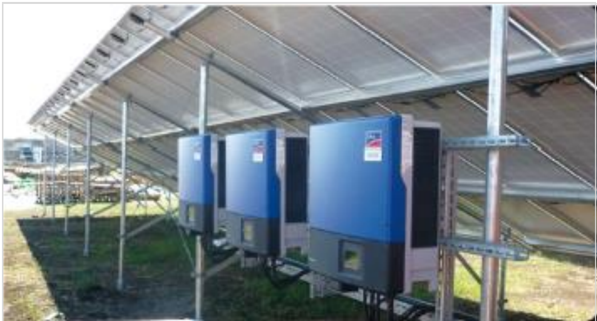
Слика бр. 21: Приказ конструкције на коју се постављају соларни панели и инвертори
